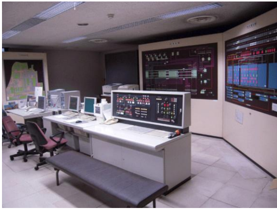
図1 ビルの中央管理室
